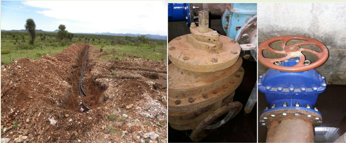
Vingerkraal pump line.
